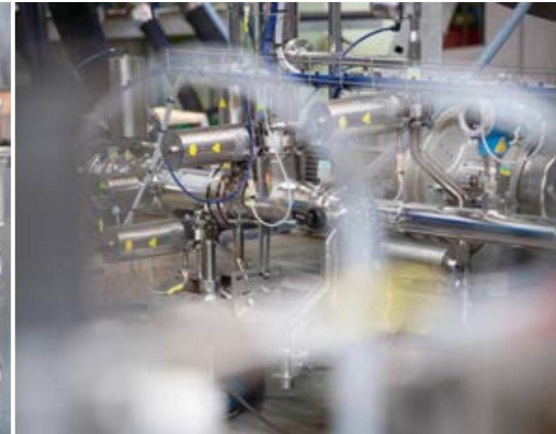
Digitale Softwaremodule übernehmen die Steuerung von Anlagenkomponenten.
